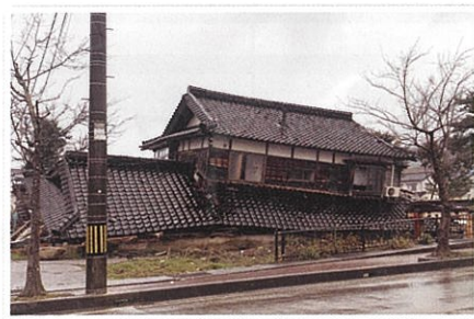
▲被災現場の様子
